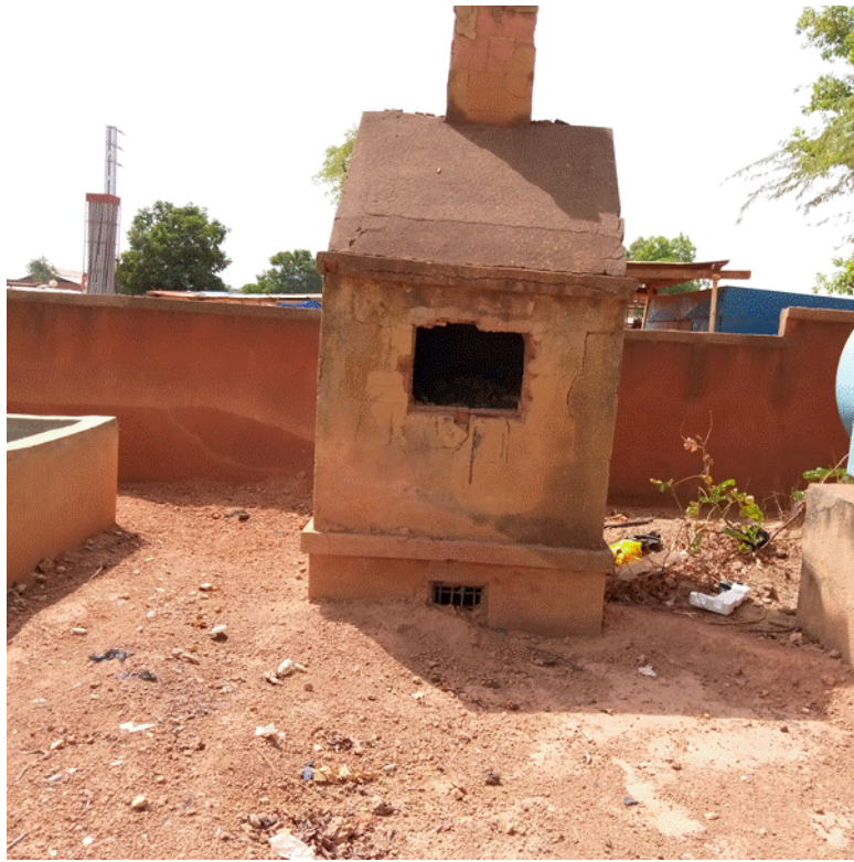
Photo 11 : Incinérateur du district sanitaire de Kossodo en panne
